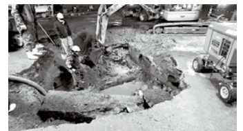
【R3.1 横田地区漏水事故】
