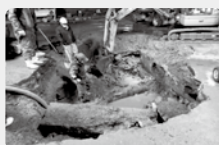
【R3.1 横田地区漏水事故】
