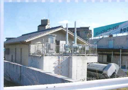
揚水能力:1分に最大180.00m 3 (雨水)
