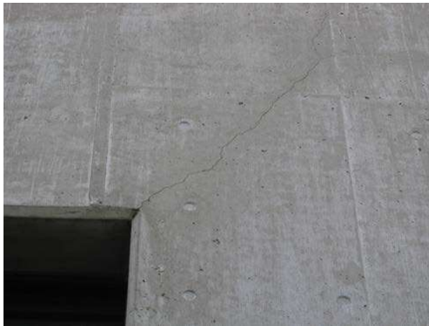
図 コンクリートのひび割れ
