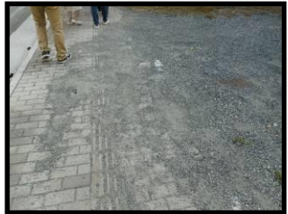
(沿道駐車場に出入りする車で、歩道上に砂利が多い)
