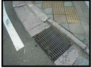
(交差点に段差があり車いすで登れない所があった)
