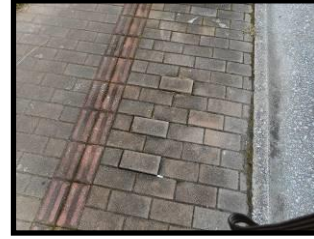
(インターロッキングがガタガタして歩きにくい)
