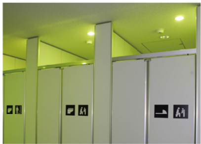
フラッシュライトの設置事例
